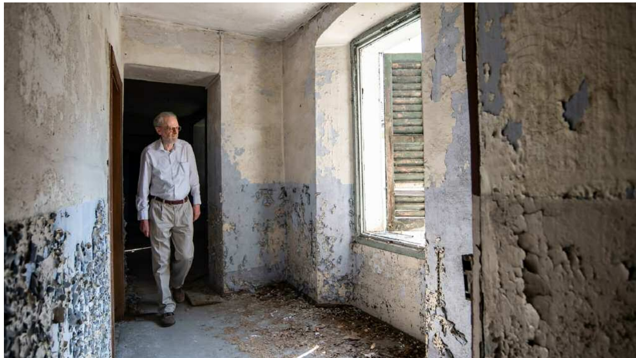
Luca Buzzi all'interno dell'edificio fatiscente di Bellinzona che necessita di una completa ristrutturazione TI-PRESS/GIANINAZZI
