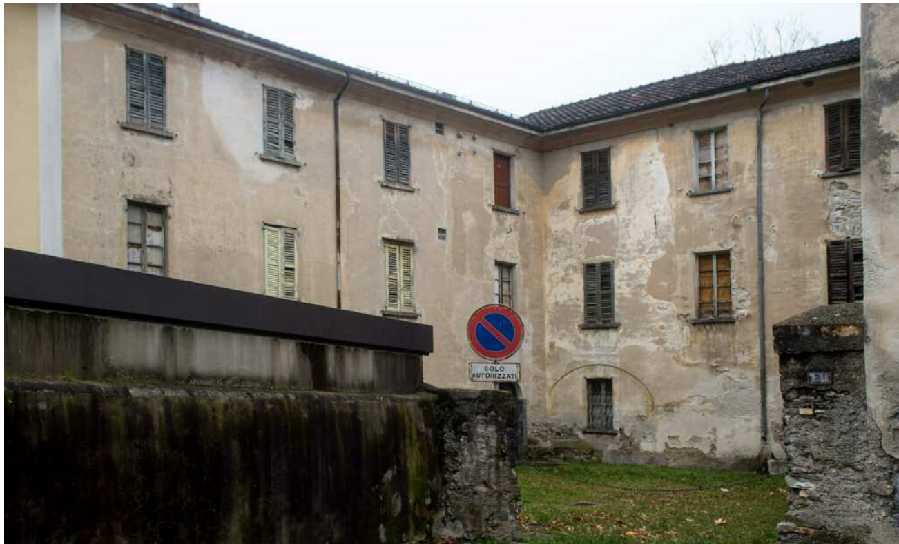
Il malconcio edificio in via Lavizzari viene messo a disposizione gratis dalla Città per 50 anni
