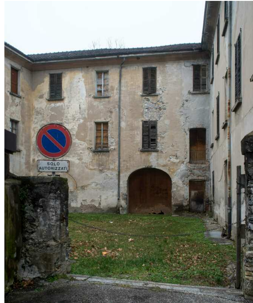
L'edificio versa da diversi anni in condizioni fatiscenti
